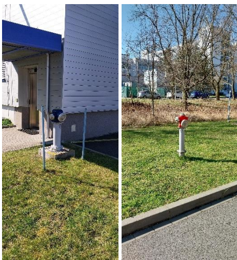
foto č. 21 a 22 – ukázka venkovních hydrantů (výtokových stojanů)
