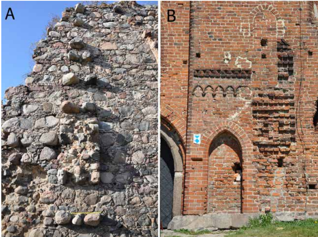
Fig. 12. Examples of toothings excavated after dismantling walls: A – stone toothings prepared for adding a partition wall in Papowo Biskupie, B – brick toothings for a wall of a gate neck in Radzyń Chełmiński. Photo B. Wasik. – Abb. 12. Die Beispiele der Schmorzen nach der vergangenen Mauern: A – steinerne Schmorzen an den Wand in Papowo Biskupie, B – Ziegelschmorzen in Radzyń Chełmiński. Foto B. Wasik.
