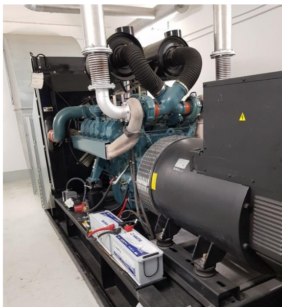
Obrázek 1: Diesel agregát v objektu centrálního výměníku
